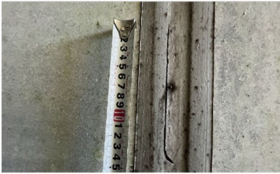
写真-2 シーリング材の劣化
